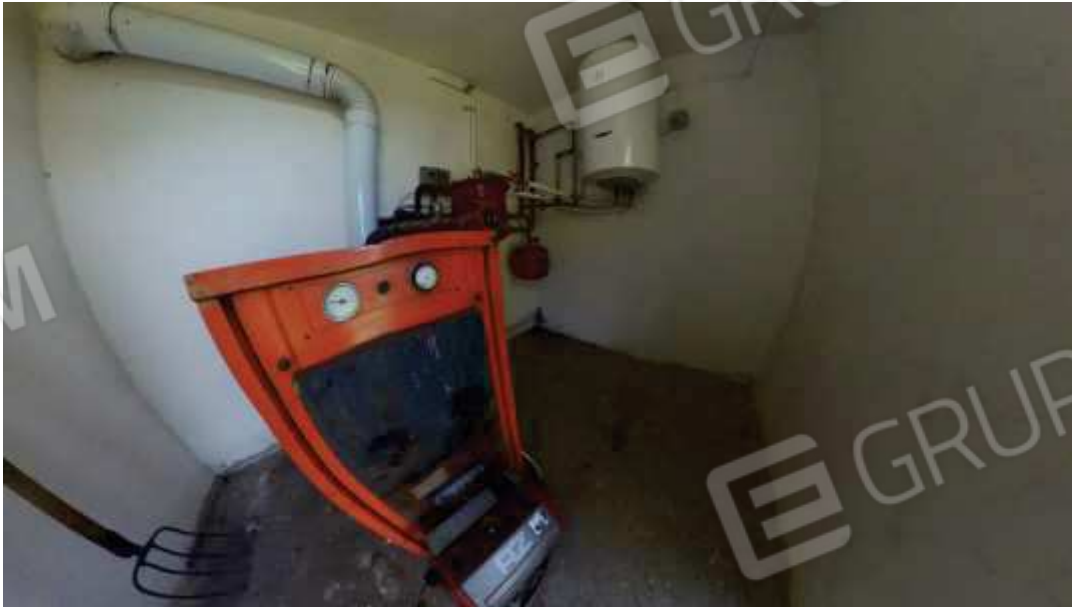
Figura 7 locale caldaia a piano terra a Ovest dell'abitazione.
