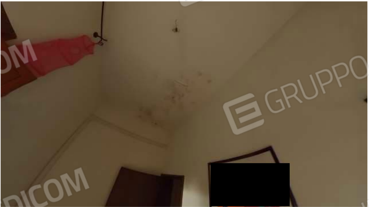
Figura 41 INTERNI PRIMO PIANO INFILTRAZIONE A SOFFITTO DELLA STANZA SINGOLA IN POSIZIONE CENTRALE
