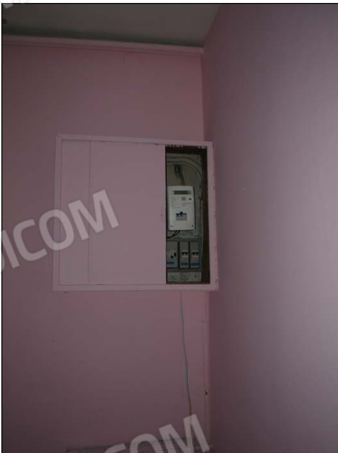
PARTICOLARE CONTATORE GENERALE ALL'INTERNO DELLA SECONDA CAMERA UN TEMPO ADIBITA A CUCINA
