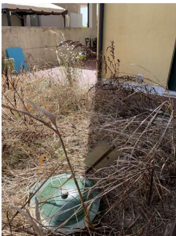
foto 17 particolare con bombolone gas GPL
