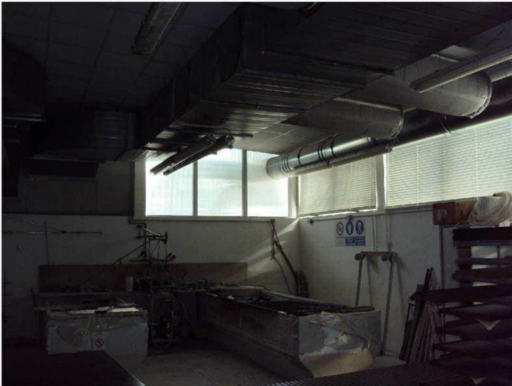
Foto n. 40: interno blocco (D1) locale verniciatura
