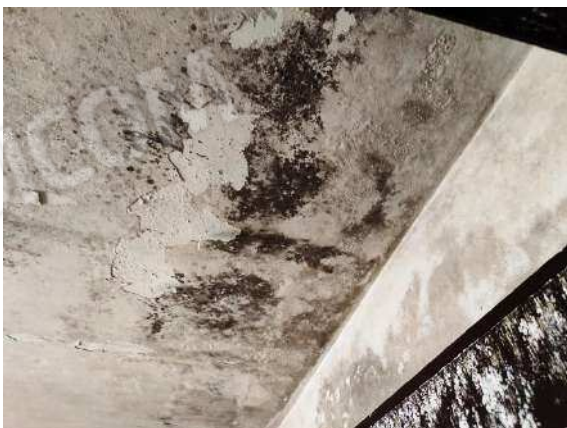
Particolare effetto delle infiltrazioni di acqua
