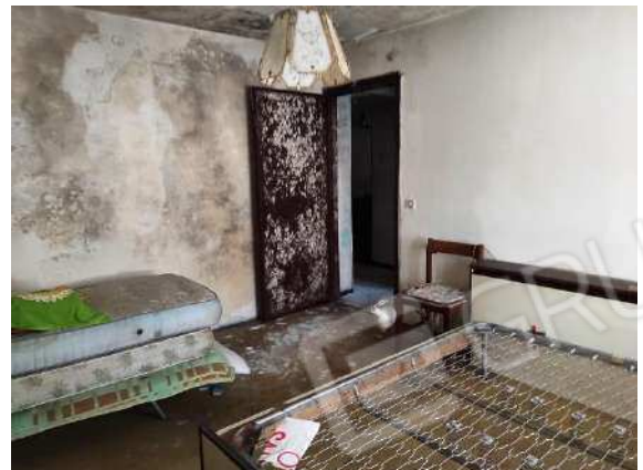
Presenza di muffa su camera matrimoniale
