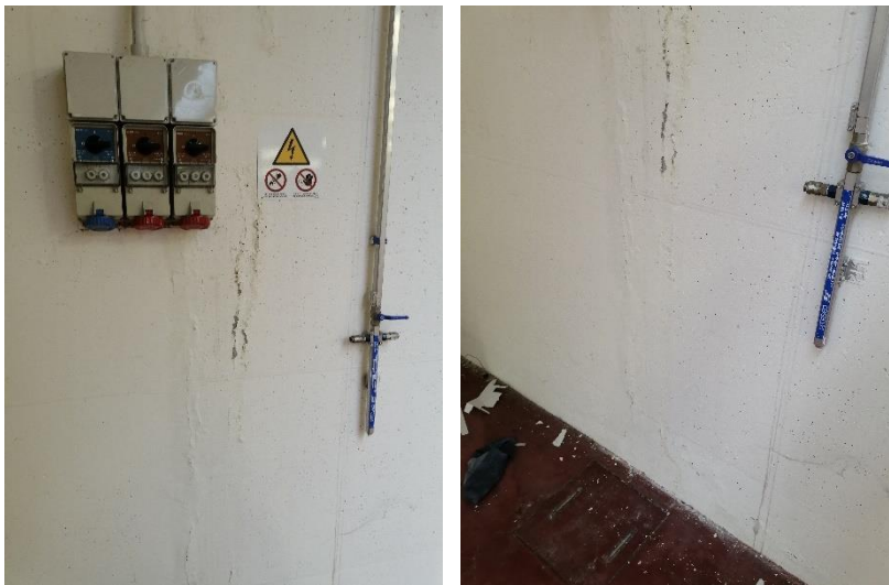
Parete perimetrale nord - particolare infiltrazione
