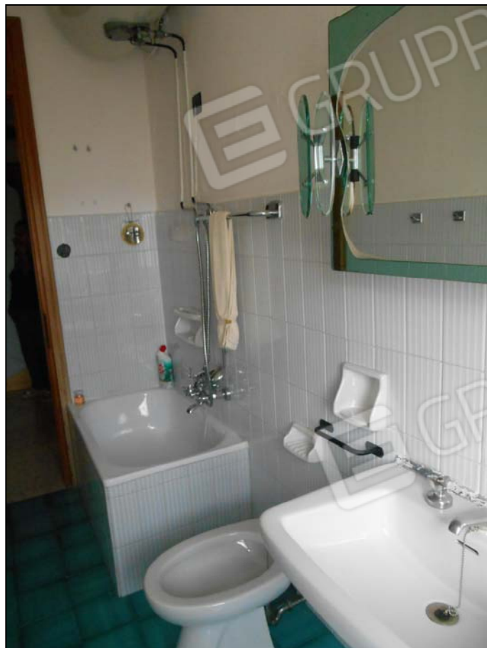
Locale bagno particolare del boiler elettrico per la produzione di acqua calda
