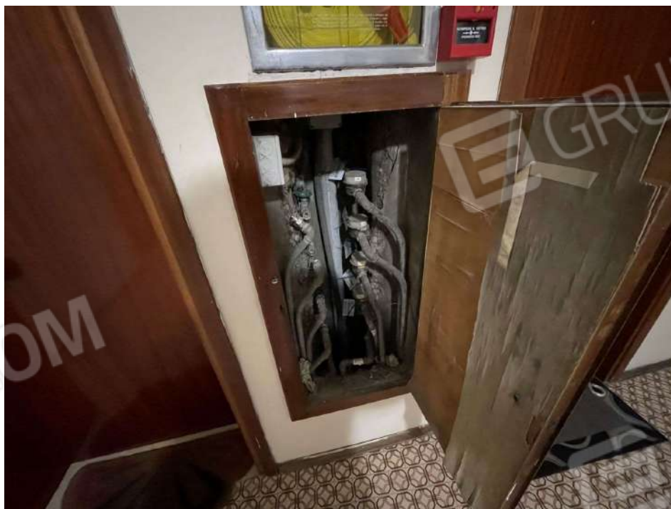
Particolare collettore al piano acqua potabile
