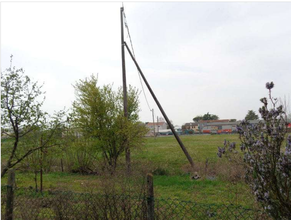
Foto n. 4: Elettrodotta aereo in bassa tensione
