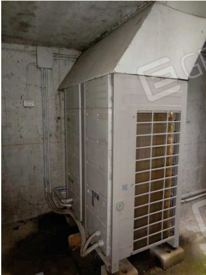
Foto 113 – piano interrato - centrale termica
