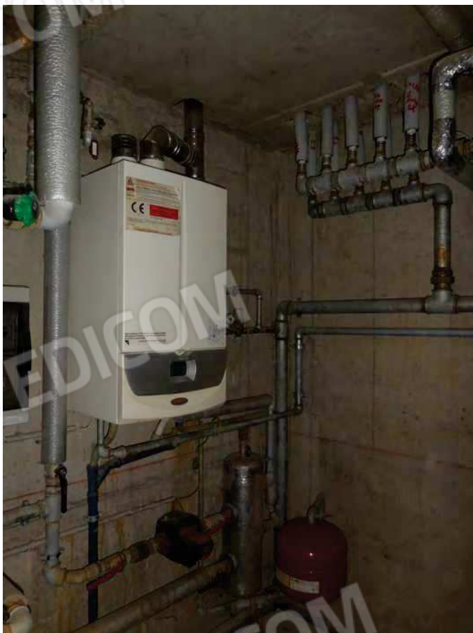
Foto 115 – piano interrato - centrale termica
