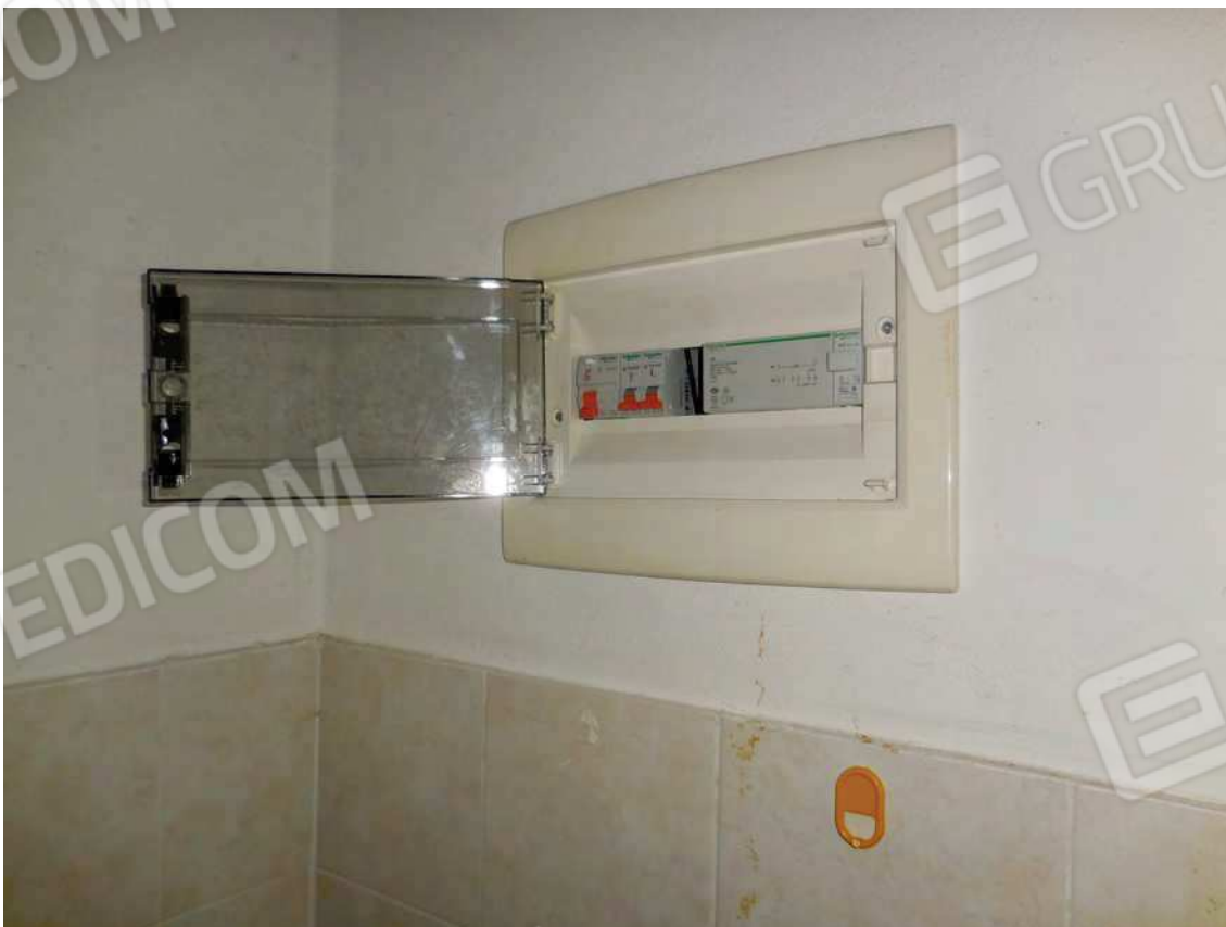
Foto27 - piano terra - bagno, particolare quadro elettrico
