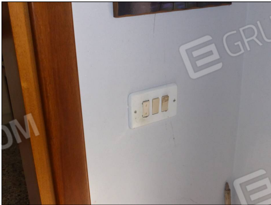
Foto n. 28 – Interruttori tipici (sono presenti varie tipologie di placche)
