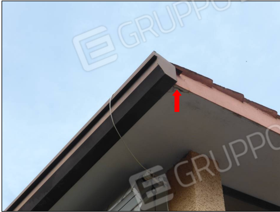
Foto n. 29 – Intonaco e porzione di calcestruzzo del solaio di copertura in fase di distacco
