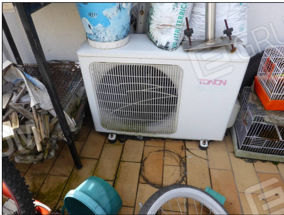
Foto n. 26 – Unità esterna climatizzatore (terrazza nord)
