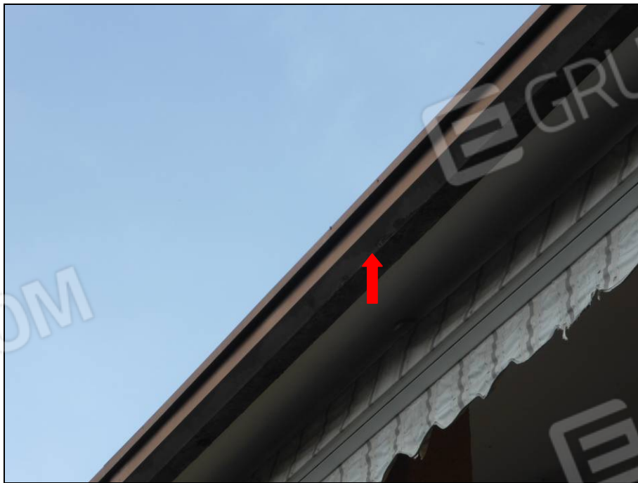
Foto n. 30 – Grondaia arrugginita e bucata
