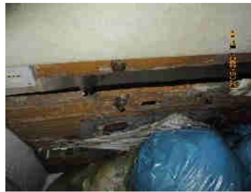
Foto n. 12: PT ripostiglio con accesso impedito al vano scala
