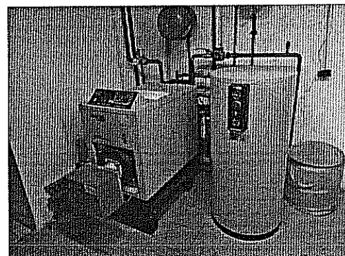
Centrale termica PS1
