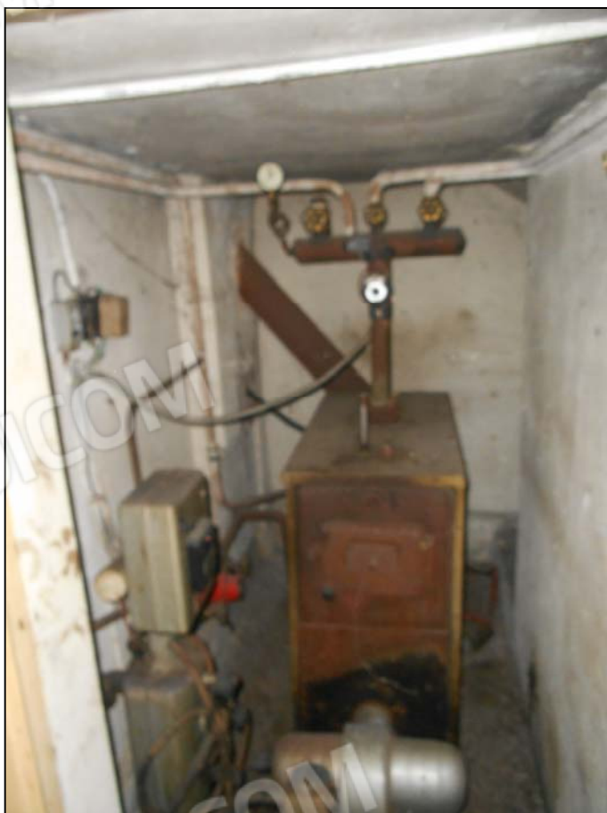
Locale C.T. ricavata nel sottoscala e accessibile dal locale lavanderia. Tutta l'impiantistica risulta essere in disuso
