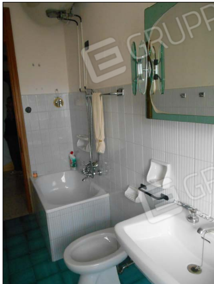
Locale bagno particolare del boiler elettrico per la produzione di acqua calda
