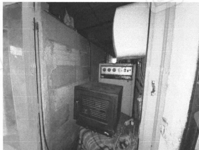
Foto 18: Locale centrale termica
