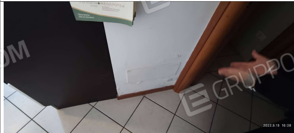
FOTO 11_TRACCE DI UMIDITA' ZONA SOGGIORNO-ANGOLO COTTURA
