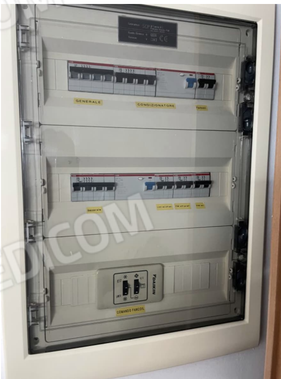
Veduta quadro elettrico interno
