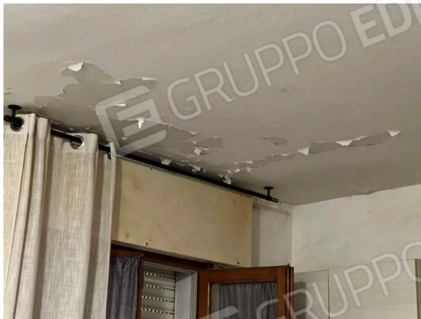
Infiltrazioni datate non riparate
