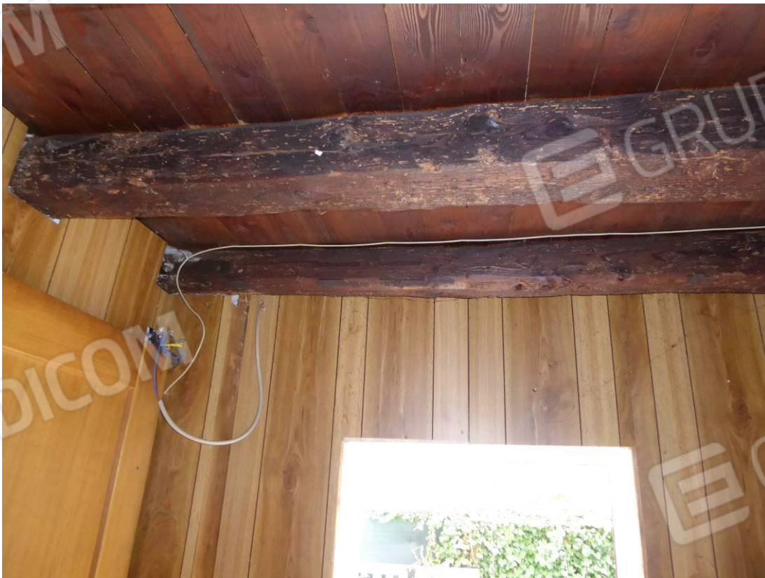
Foto 18 – Part. 30 sub. 2 magazzino angolo sud/ovest
