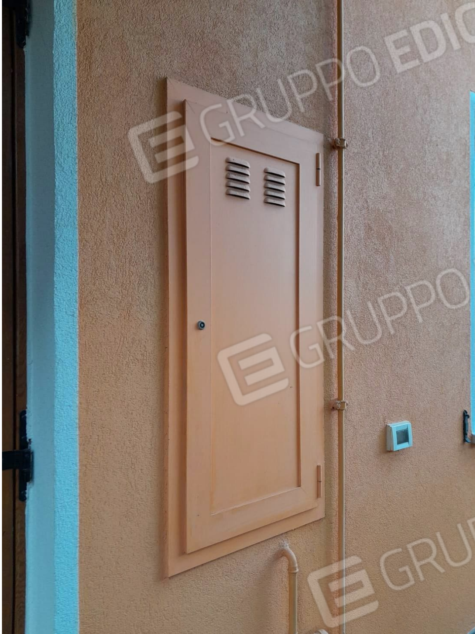
FOTO N.08_Particolare cassetta gas
