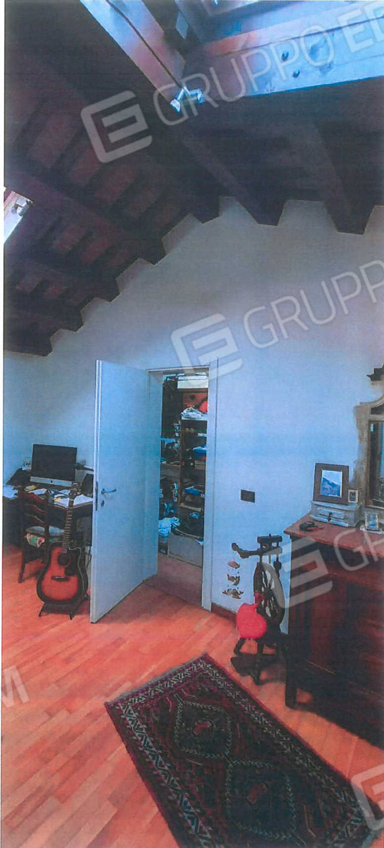
Zona Sottotetto – 1 con vista della porta del Sottotetto-5 (abusivi)
