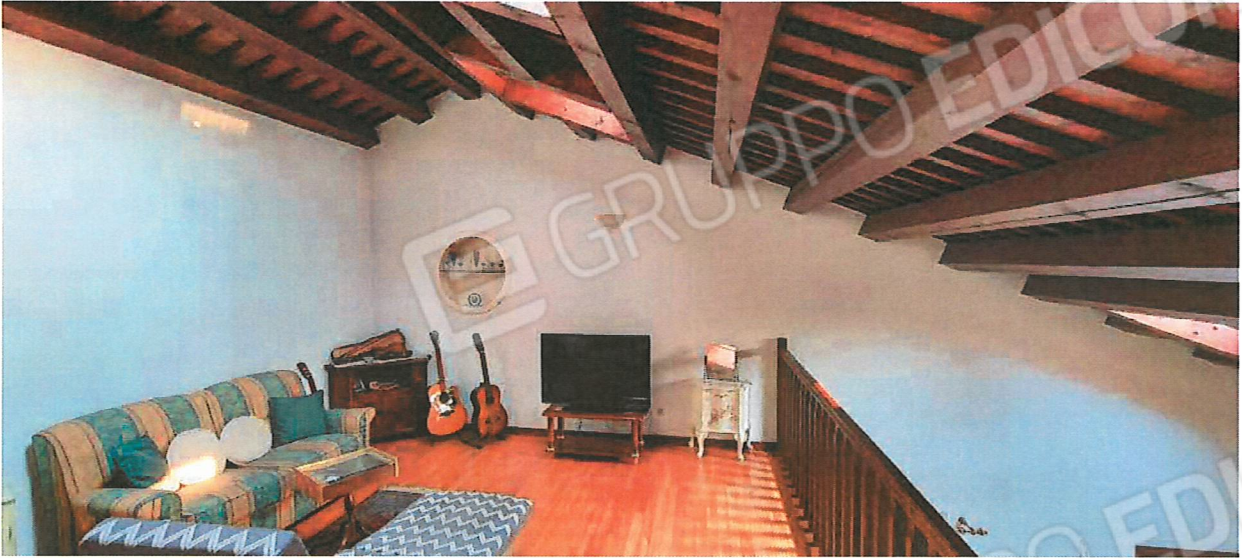
Sottotetto – 3 Soppalco (abusivo)
