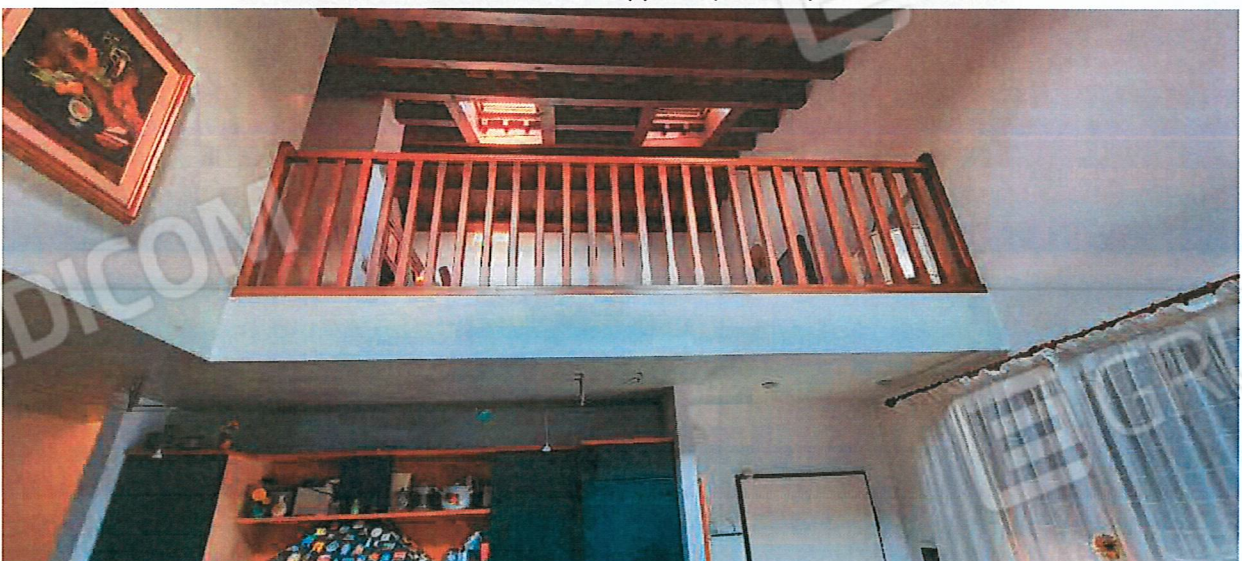
Sottotetto – 3 Soppalco (abusivo)
