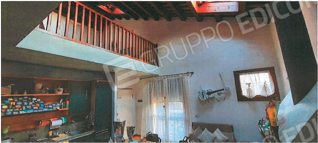
Vista del soppalco abusivo
