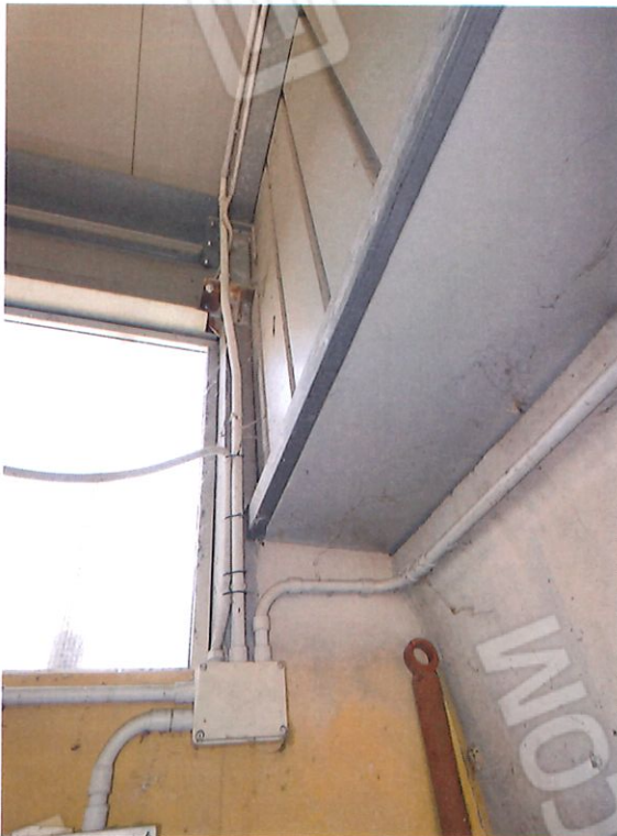
foto 14 -15 impianto elettrico dettagli
