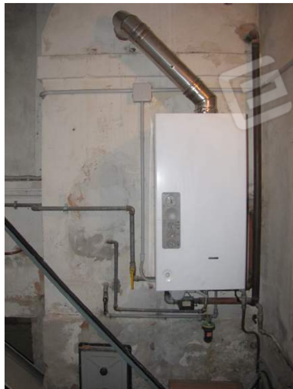
Magazzino al Piano Terra con vista della caldaia a gas
