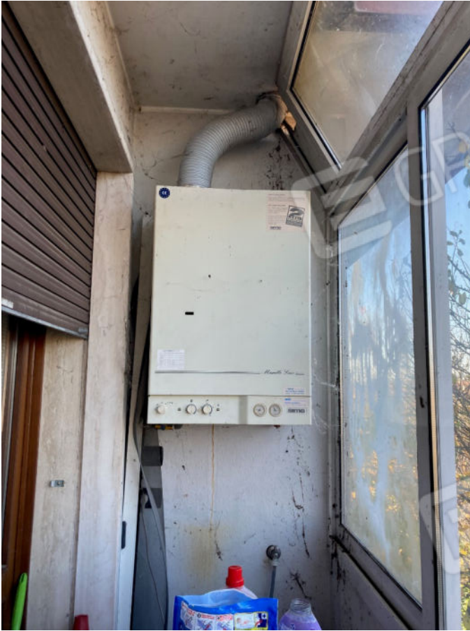
Foto n. 22: caldaia posta in terrazza
