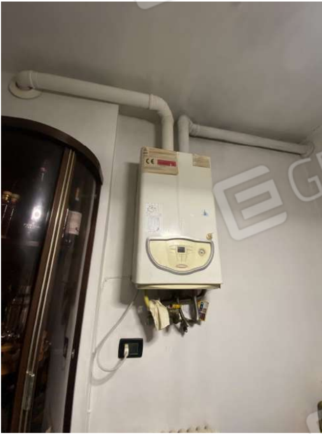
FOTO 13: Caldaia ubicata in cucina
