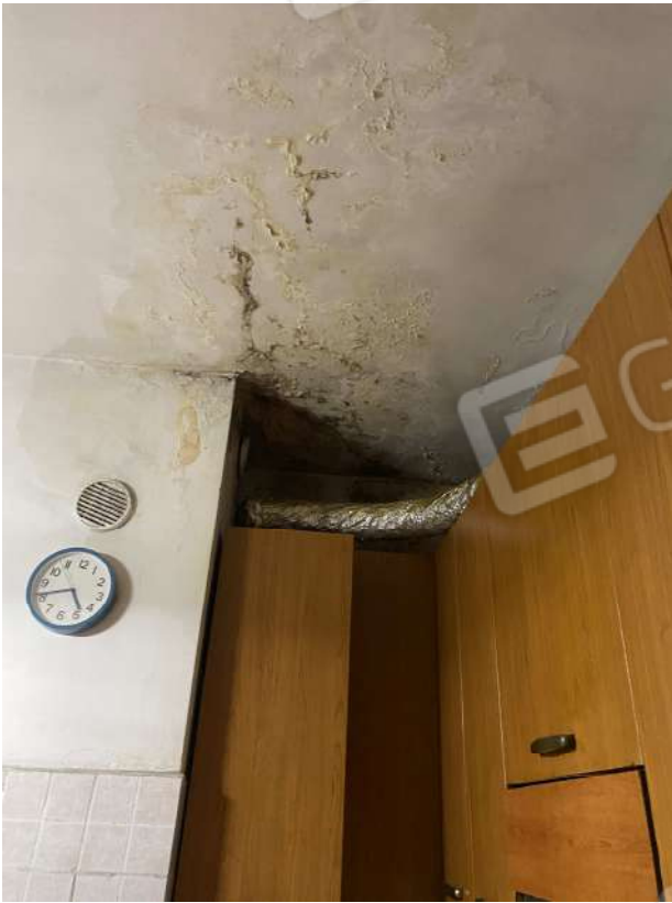
FOTO 15: Infiltrazioni e muffa in cucina
