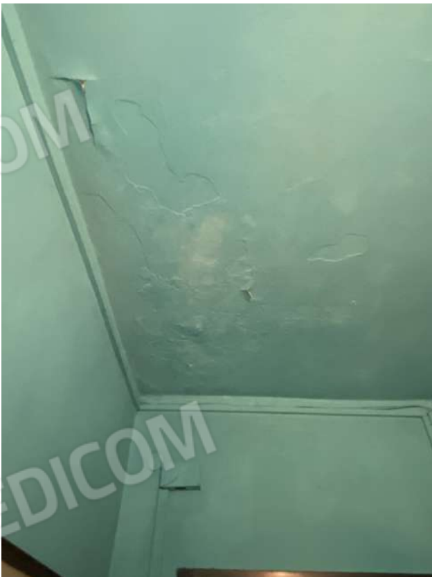
FOTO 8: Evidenti problemi di infiltrazioni/umidità
