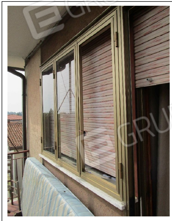
Fotogramma 13 – stato delle finestre – rotture.
