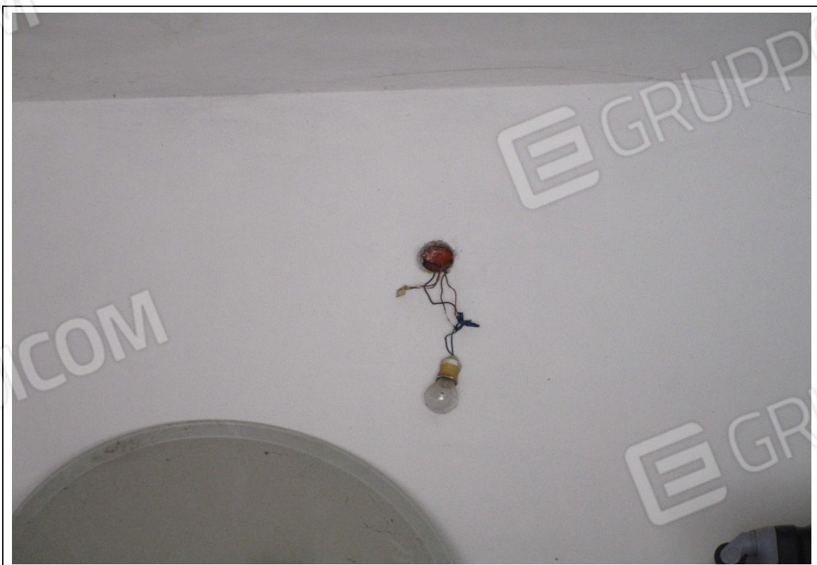
Fotogramma 2 – Particolare interno garage – impianto elettrico.
