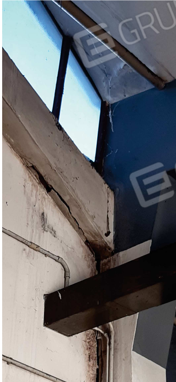
Particolare delle infiltrazioni meteoriche dai serramenti delle volte
