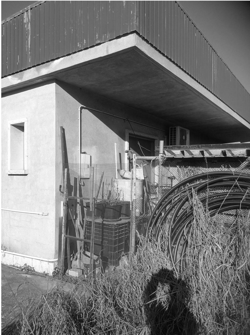
Foto da cui si vede una finestra conforme al progetto; non un uscita con portafinestra come rappresentata in catasto.
