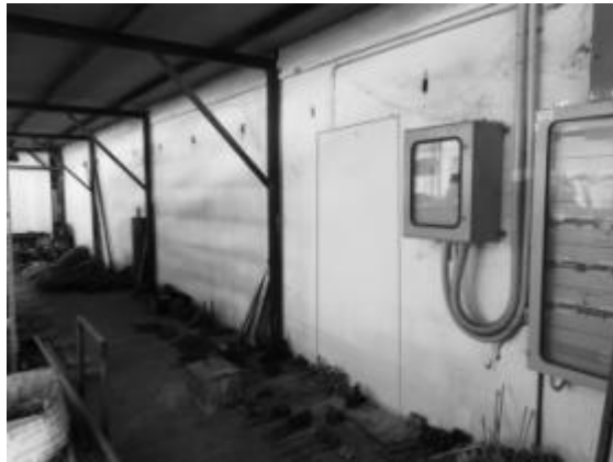
Foto della parete lato capannone con sagoma della porta di comunicazione murata
