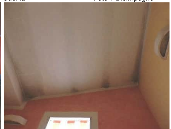
Foto 10 Muffe sul soffitto del vano scale
