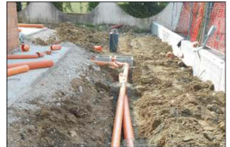
FOTO 2 - Unità acque separate unita n°1
