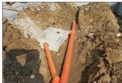
FOTO 1 - pozzetto degrassatore unita n°2
