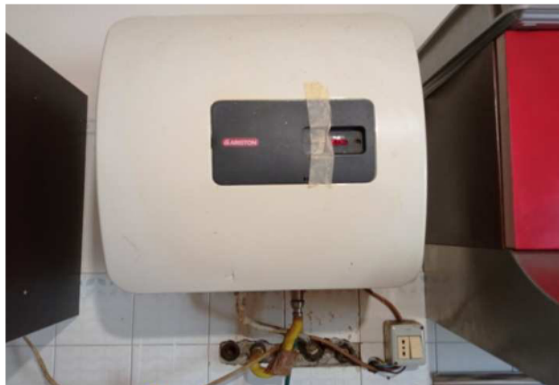
foto 3 - La caldaia scalda acqua installata nella cucina, è funzionante a gas metano, la cui utenza risulta non attiva e i fornelli della stessa cucina sono alimentati con bombola, il tutto privo di certificazioni di corretta e sicura posa in opera.
