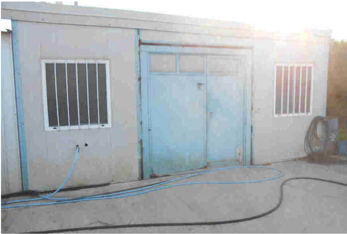
manufatto prefabbricato lato lavaggio automezzi
