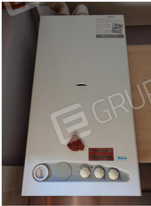
12 Caldaia di tipo murale nel vano cucina
