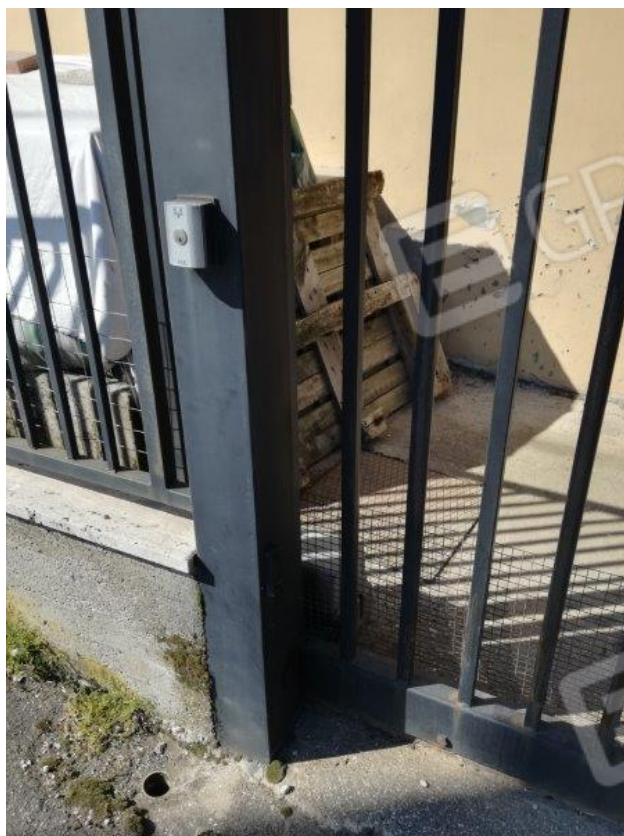
Foto 22: particolare chiave motorizzazione cancello
