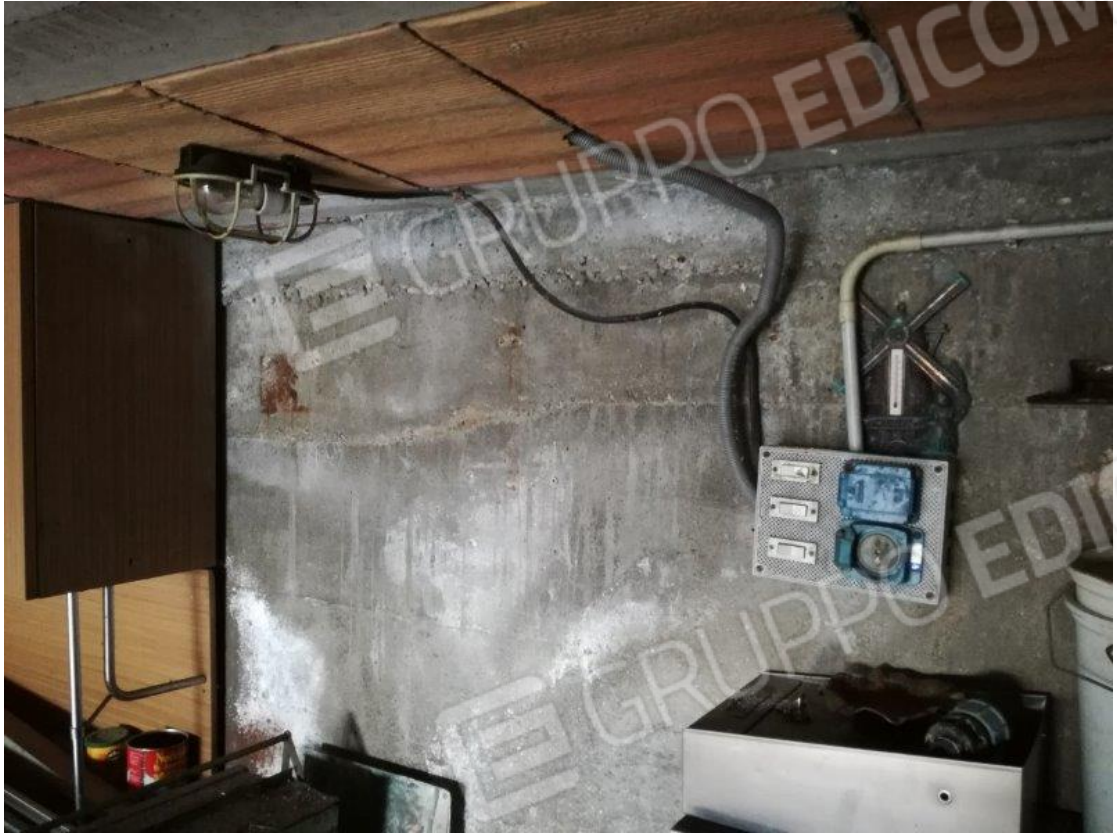
Foto 9: impianto elettrico esterno
