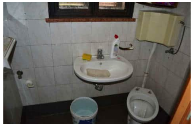
foto 22 - scorcio del w.c. coi sanitari e l'impianto termo-sanitario da verificare
