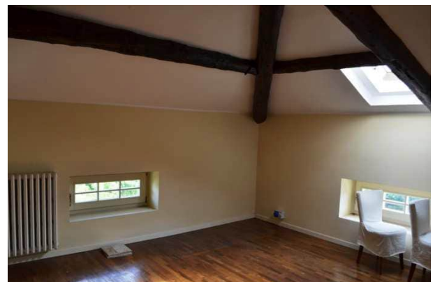
foto 21 - scorcio della stanza nord est del sottotetto con finestra velux autorizzata
