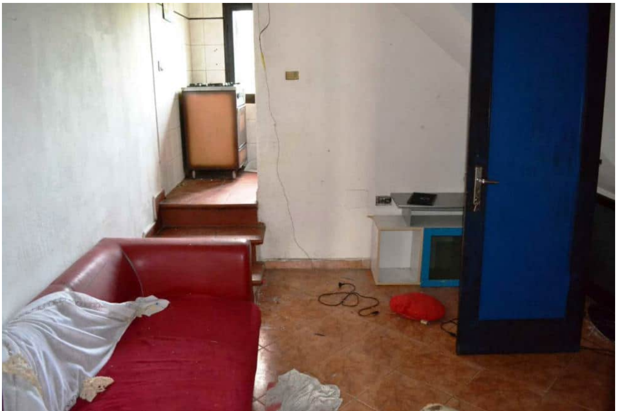
foto 23 – ABITAZIONE m.n. 533 sub 2, piano 1° - vista da nord dell'ingresso dal vano scala (porta a destra della foto) del monolocale spartito a piano 1°, con l'angolo cottura a sud est in posizione di antibagno, incompatibile con i minimi requisiti igienico-sanitari vigenti e quindi da ripristinare secondo il progetto autorizzato o con soluzioni conformi ai criteri di norma
