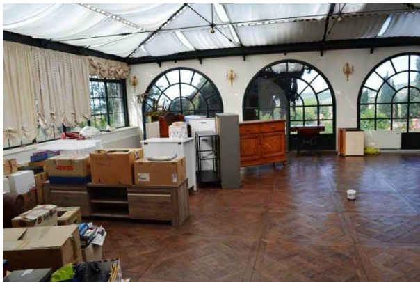
foto 10 - scorcio del plateatico sud ovest con la vetrata di copertura non autorizzata
