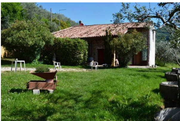
foto 18 - vista da sud del rustico sui m.n. 91-190 con tettoia collabente
