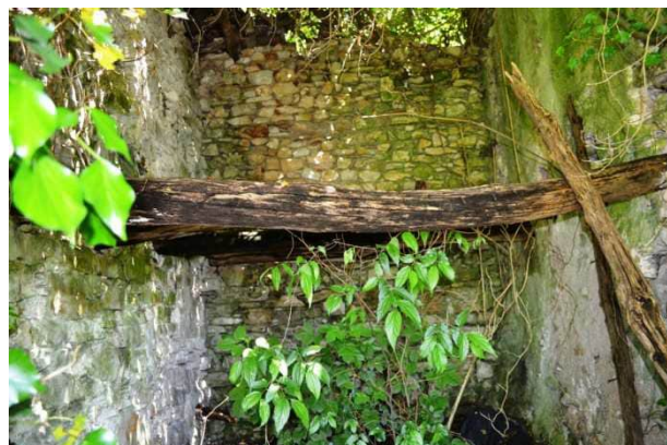
foto 12 - scorcio interno del rustico collabente di trevani visto dallo stradello dell'oliveto
