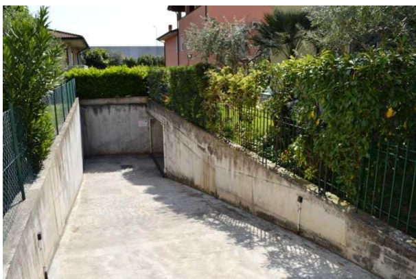
foto 36 - vista dal cancello d'accesso carraio sulla recinzione ovest della rampa del garage
