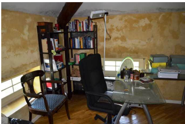
foto 20 - scorcio della zona soffitta a sud ovest del sottotetto, con igrofanie alle pareti
