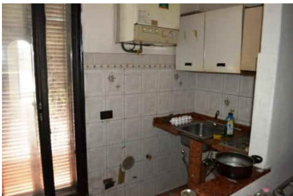
foto 21 - l'angolo cottura sud est con la caldaia a parete da verificare e la porta del terrazzo
