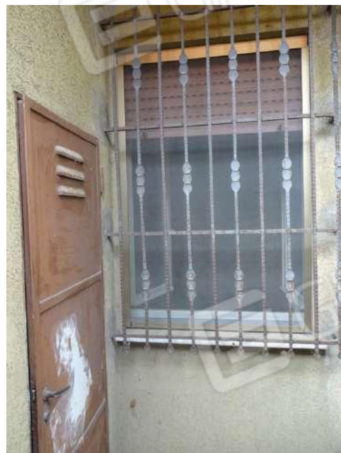
centrale termica nel sootoscala
