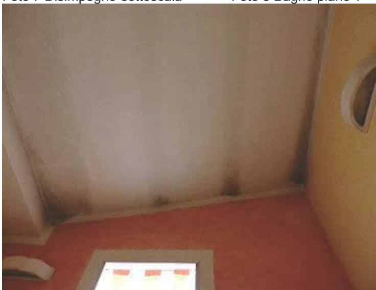
Foto 10 Muffe sul soffitto del vano scale
