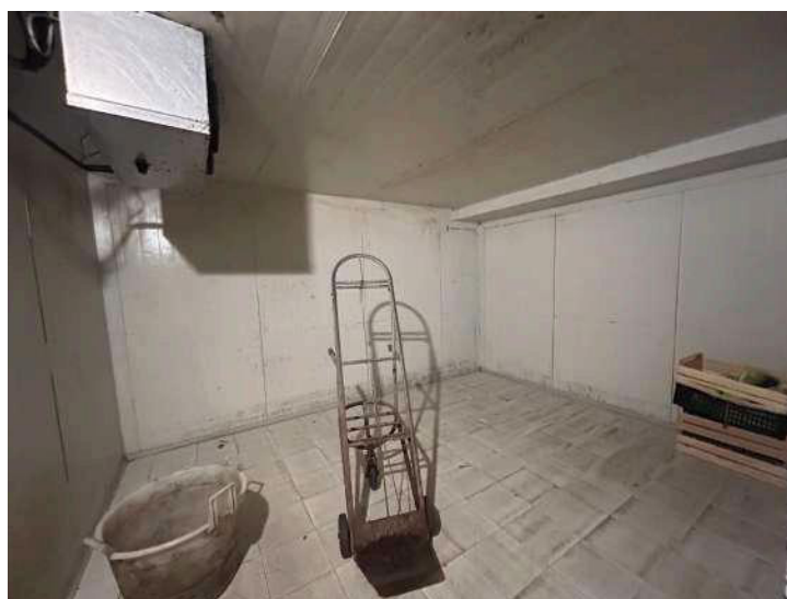
Cella frigorifera - p. interrato
