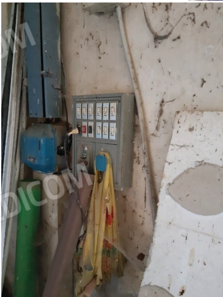
particolare quadro elettrico non funzionante.
