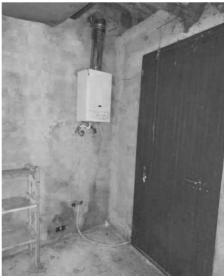
43. caldai per produzione acqua calda non a norma
