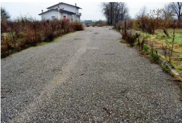
foto 1 - vista da sud in via Don R. Tressino della strada d'accesso del PUA ORTI 3 costituente opera di urbanizzazione primaria convenzionata larga m 7,00, con marciapiedi di m 1,50 e con binder in pessime condizioni – senza manto d'usura. In alto a destra si vede l'edificio di terzi realizzato al rustico sul lotto n. 3 (non staggito)
