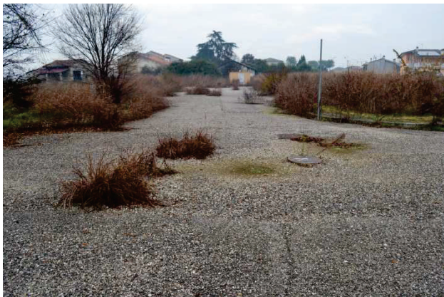
foto 2 - vista dall'incrocio centrale (in primo piano) della viabilità interna del PUA ORTI 3 del tratto est della strada per l'accesso ai lotti larga m 7,00, con marciapiedi di m 1,50 e parcheggi di m 2,50 e con binder in pessime condizioni - senza manto d'usura. Sullo sfondo al centro si vede la cabina elettrica installata sul m.n. 275
