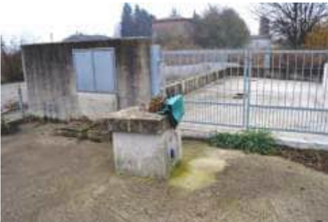
foto 20 - Particolare impianti installati sul m.n. 265
