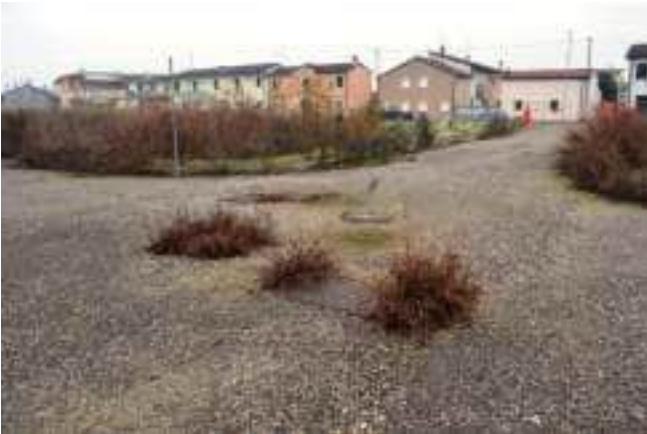
foto 10 - Scorcio delle condizioni del binder all'incrocio
