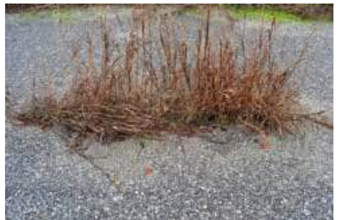
foto 23 - Particolare ammaloramento binder stradale
