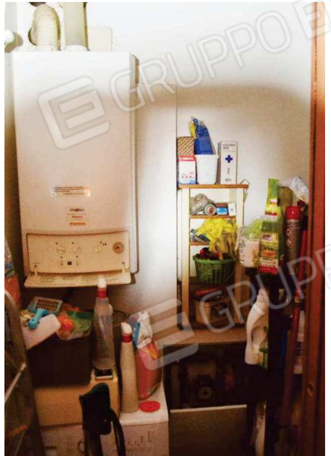
foto 12 - Ripostiglio con la caldaia autonoma
