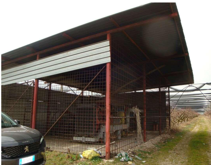
Tettoia insistente sul mapp. 910
