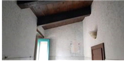
Vista interna dell'abitazione (nel bagno) da cui si rileva il nuovo solaio di copertura e l'assenza del solaio di sottotetto
