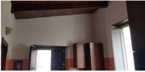
Vista interna dell'abitazione (nella cucina) da cui si rileva il nuovo solaio di copertura e l'assenza del solaio di sottotetto
