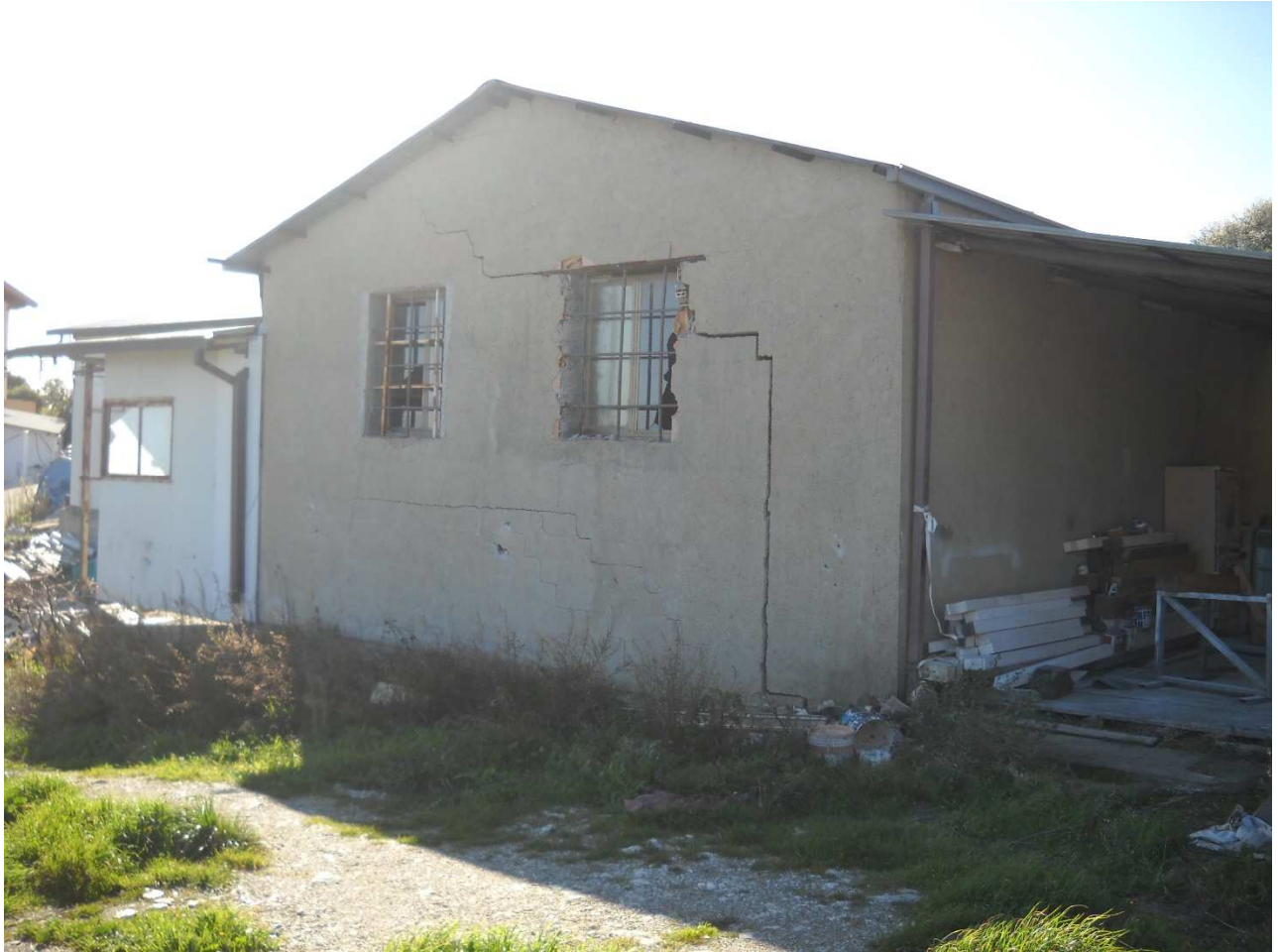
Il prospetto esterno con lesioni e cedimento della compagnatura
