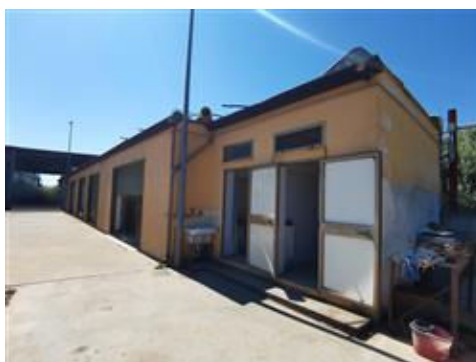
Fabbricato F1 all'interno della particella 502 realizzato senza titoli autorizzativi
