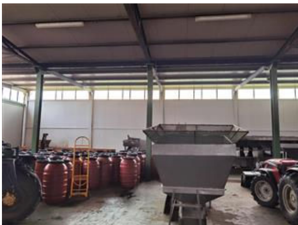
Foto 1 - Porzione ampliata e chiusa abusivamente con pareti coibentate
