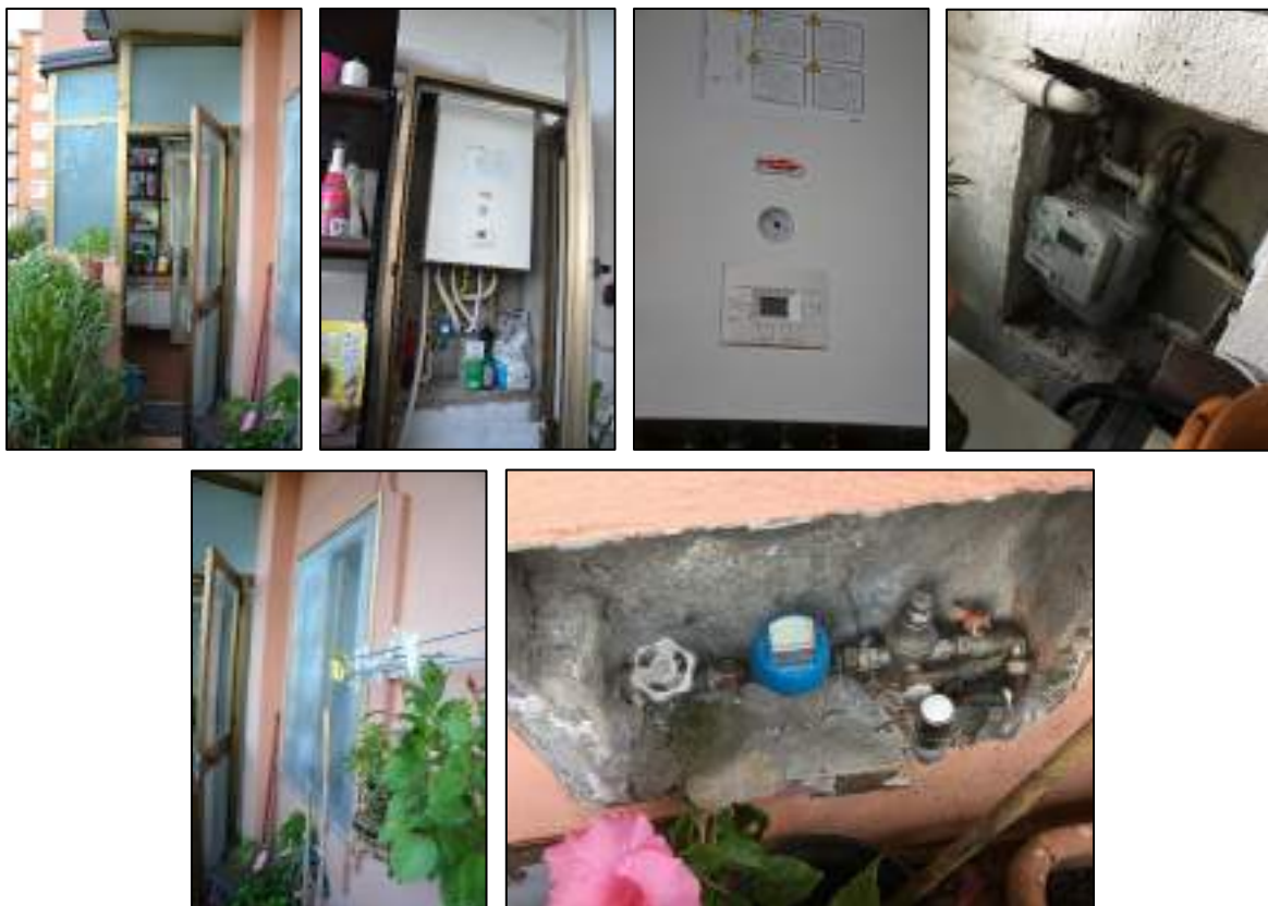
Figura 37 – Impianto di riscaldamento e produzione di acqua calda sanitaria
