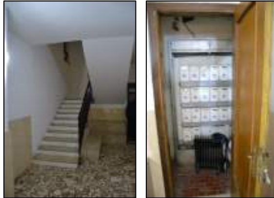
Figura 35 - Contatore fornitura energia elettrica
