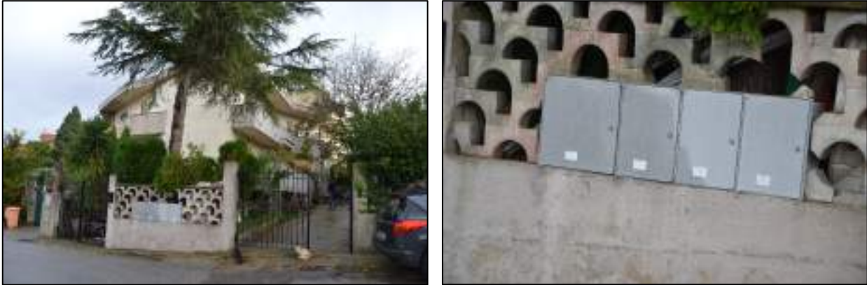
Figura 38 - Contatore fornitura energia elettrica
